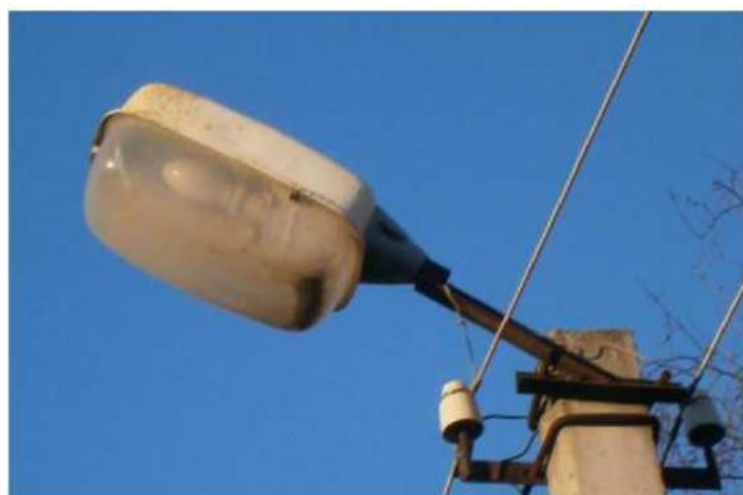
Figura 5. Starea corpurilor de iluminat stradale
